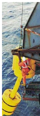
Junta flexível conectando o primeiro SCR (steel catenary riser) projetado e instalado no Brasil à plataforma semi-submersível Petrobras18.
